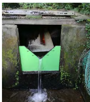
写真 3. 取り付け直後の三角堰
